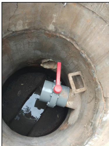
已完善雨水应急阀门建设
